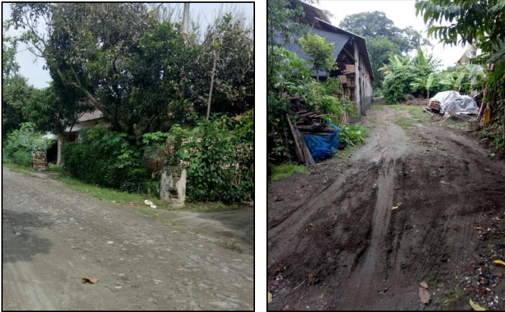
Gambar 4. 24 Perkerasan Jalan Tanah dan Makadam pada Daerah Peternakan dan Distributor Telur Ayam Ras di Kecamatan Ponggok
