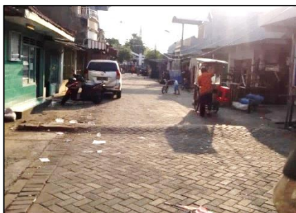
Gambar 3. 5 Kondisi Jalan di Jalan Sidotopo IV
