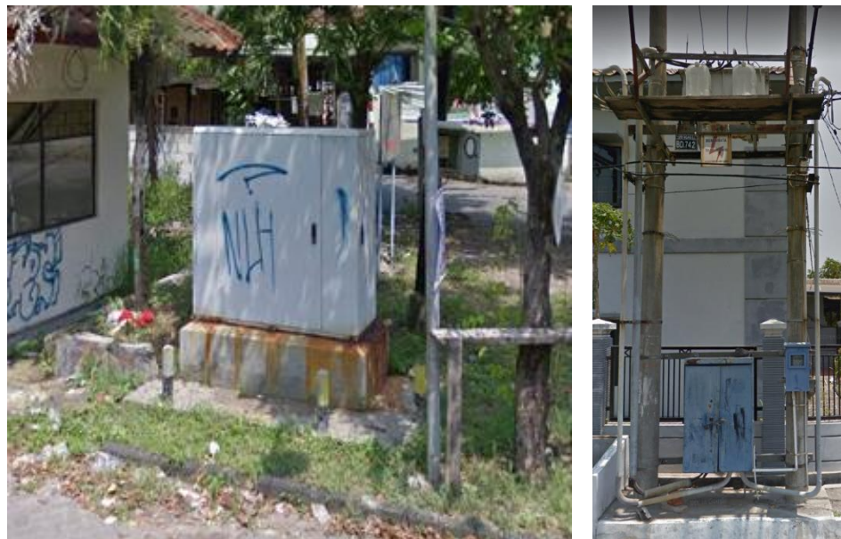
Gambar 6. Panel Box dan Trafo
