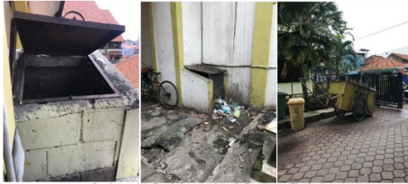
Cerobong dan Gerobak sampah pada Rusunawa Sombo
