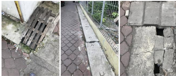
Jaringan Drainase pada Rusunawa Sombo
