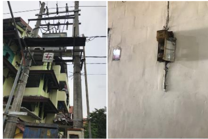
Sistem Jaringan Listrik pada Rusunawa Sombo
