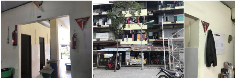
Sarana Proteksi Kebakaran berupa APAR 3 kg dan 5 kg Kepadatan Bangunan yang Cukup Tinggi & Tidak ada nya APAR pada beberapa Blok
