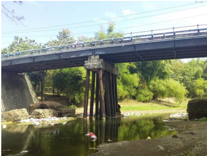
Gambar 1. 8 Kondisi Existing Terdapat Aliran Air
