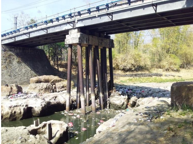
Gambar 1. 7 Kondisi Existing Tidak Ada Aliran Air
