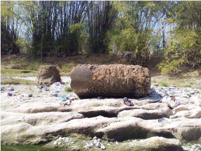
Gambar 1. 12 Kondisi Pilar Jembatan Terbawa Arus
