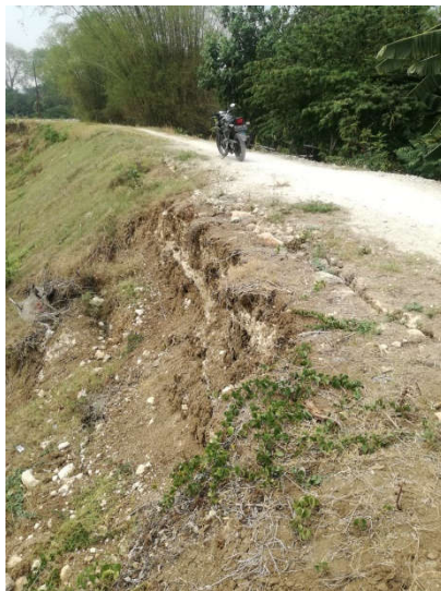
Gambar 1. 8 Tampak samping kondisi tanggul yang mengalami kelongsoran (Sumber: Dokumentasi Pribadi)
