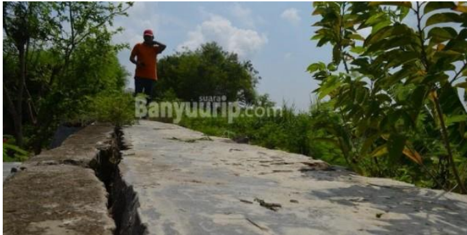
Gambar 1. 3 Dinding Parapet di Kedungharjo, Tuban Retak
