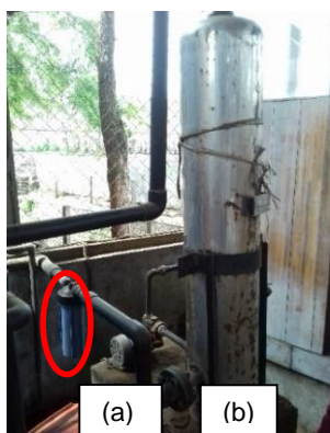
Gambar 2.24 (a) Catridge Filter (b) Reaktor Ozon yang Telah Rusak
