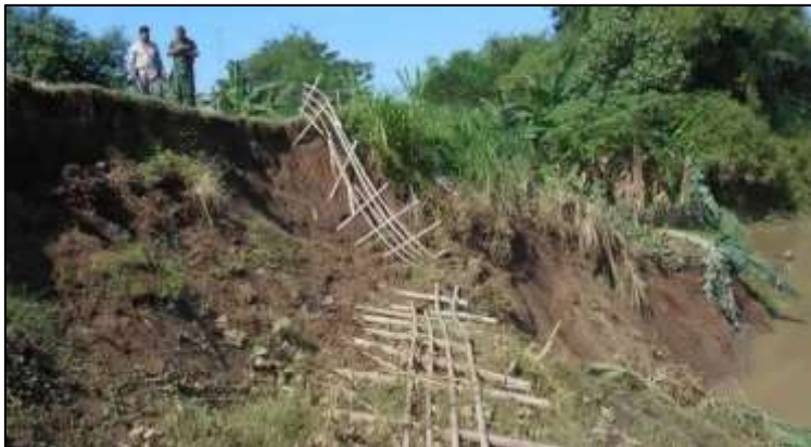
Gambar 1. 5 Akibat dari fluktuasi muka air Sungai Bengawan Solo, terjadi kerusakan pada jalan inspeksi sekitar sungai Bengawan Solo (Sumber : https://www.inews.id/daerah/jatim )
