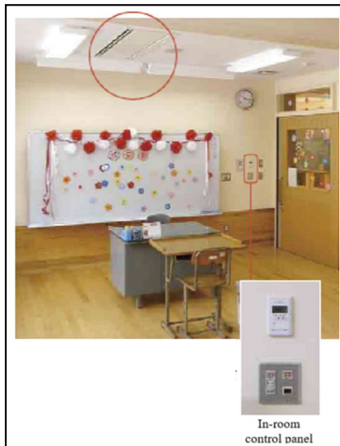
Gambar 2.53 Terdapat In-room Control Panel untuk Air-conditioning dan Humidifying pada Ruang Kelas Sumber: Jun Ueno (hlm. 5)
