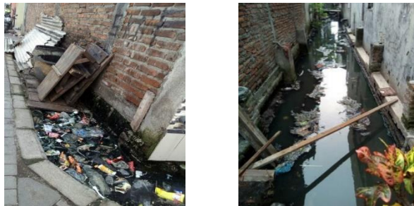
Gambar 4. 11 Kondisi Saluran Drainase RW 07 Kelurahan Wonokusumo
