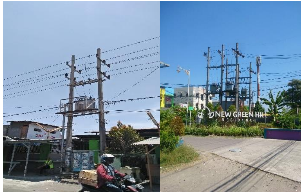
Gambar 4. 20 Prasarana Jaringan Listrik
