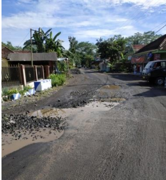
Gambar IV. 61 Kondisi Jalan Berlubang di Desa Gondoruso Sumber : Survei Lapangan, 2019
