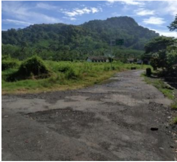
Gambar IV. 65 Kondisi Jalan Menuju Dusun Dampar Sumber : Survei Lapangan, 2019
