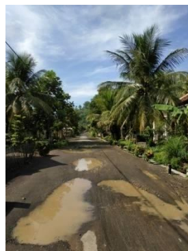
Gambar IV. 68 Jalan Makadam yang Digenangi Air Sumber : Survei Lapangan, 2019
