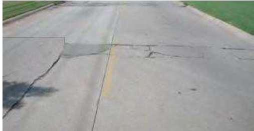
Gambar 2.6 Retak sambungan pelebaran jalan ( widening crack ) Sumber : Ziantono, 2016
