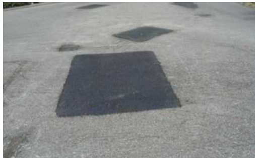
Gambar 2.18 Penurunan Pada Bekas Penanaman Utilitas ( Utility cut depression )
