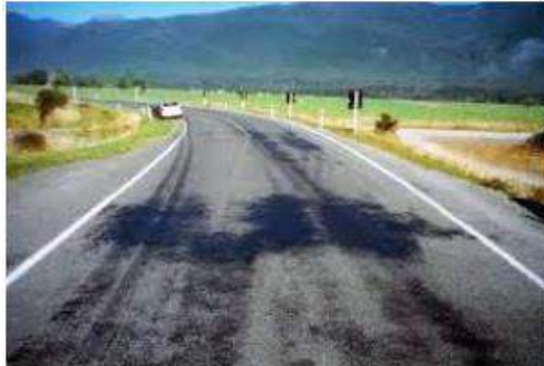
Gambar 2.17 Kegemukan (Bleeding or flushing)
