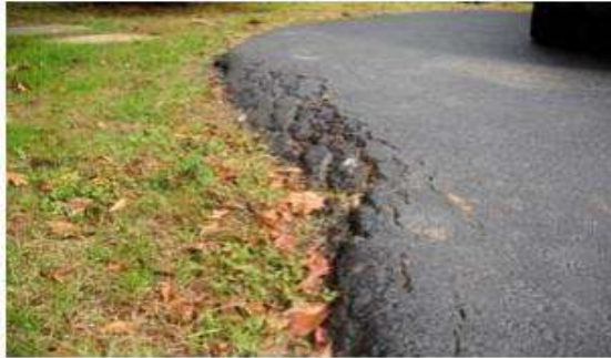
Gambar 2.3 Retak pinggir(edge crack)
