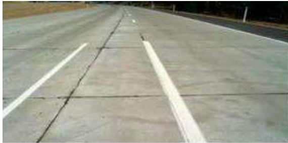
Gambar 2.5 Retak sambungan jalan ( lane joint crack )
