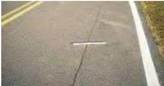
Gambar 2.4 Retak sambungan bahu dan perkerasan ( edge joint crack )
