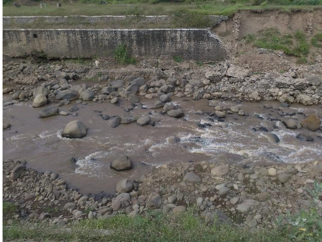
Gambar 4. 17 Bongkaran pasangan batu revement (sumber : data)
