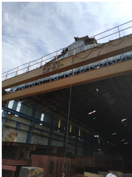
Gambar 4.18. Crane pada bengkel lambung selatan
