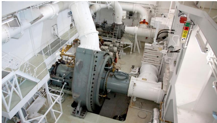
Gambar 2.19. Pompa keruk di dalam ruang pompa TSHD
