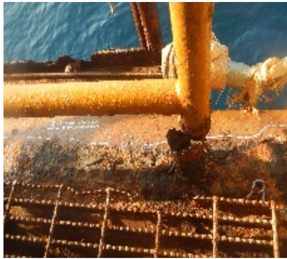
Gambar 2. 5. Korosi yang Terjadi pada Horizontal Brace A1-A2
