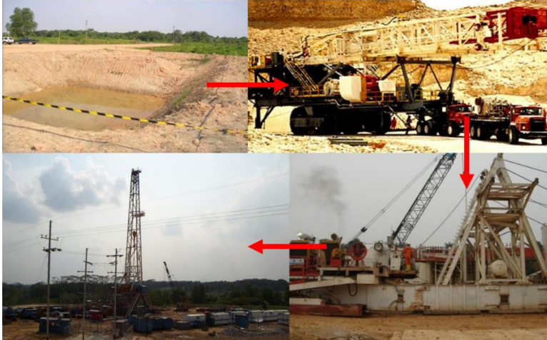
Gambar 2.1 Tahapan Persiapan Lokasi, Transportasi, Pemasangan Substructure , Overhead Tools sampai Penyelesaian Akhir Rig [4]
