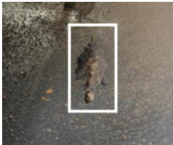
Gambar 4. 4 Korosi Internal pada Pipa (Sumber: Iman, 2014)
