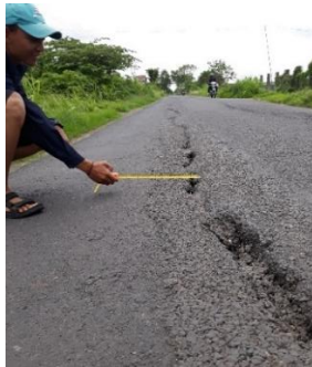
Gambar 4.3 Longitudinal Cracking (Retak Memanjang)
