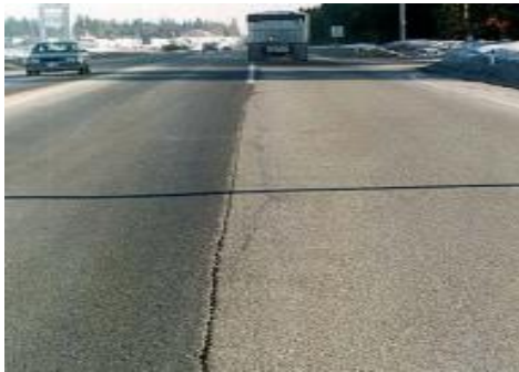
Gambar 2.4 Retak Sambungan ( edge joint crack )
