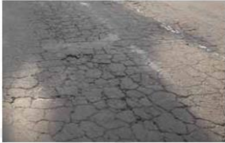
Gambar 2.2 Retak kulit buaya ( alligator cracking )
