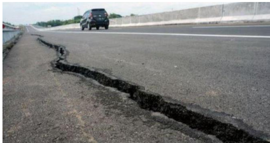
Gambar 2.3 Retak pinggir ( edge crack )
