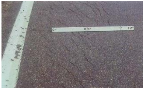
Gambar 2.9 Retak selip ( slippage cracks )
