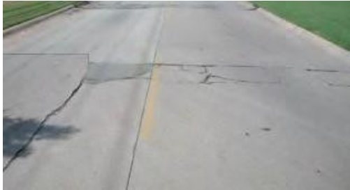
Gambar 2.6 Retak sambungan pelebaran ( widening cracks )
