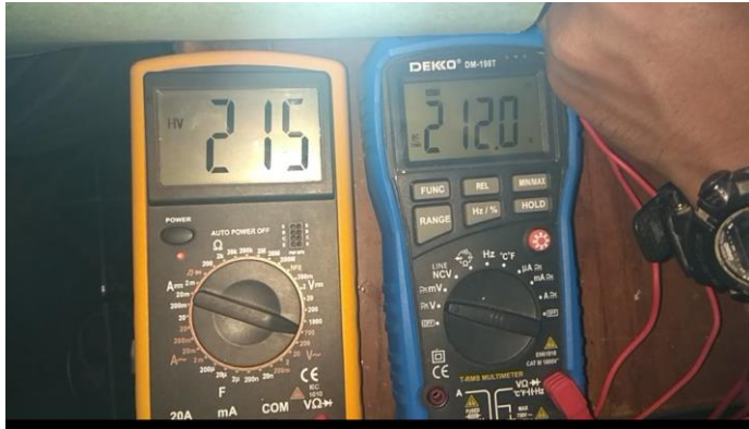
Validasi tegangan AC menggunakan 2 Multimeter
