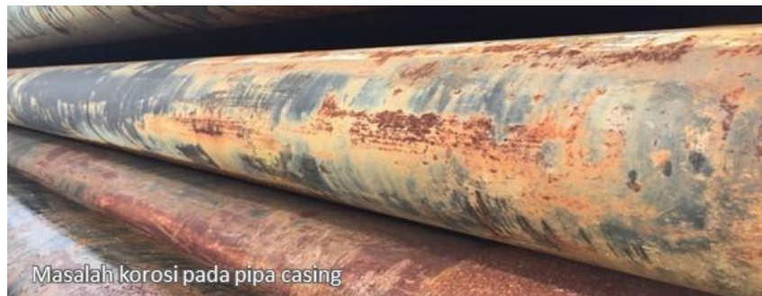
Gambar 2. 4 Eksternal Korosi pada Pipeline
