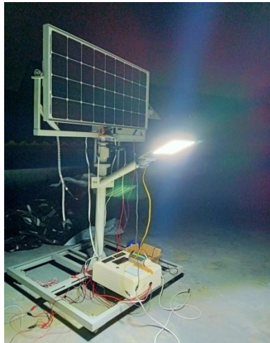
Gambar 4. 21 Pengujian lampu jalan 50 watt
