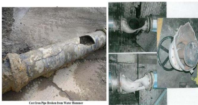
Gambar 2. 3 Dampak water hammer yang terjadi pada pipa Sumber: Mahanna, Loeb and Magalhaes, 2014
