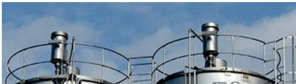
Gambar 4. 19 Filter udara pada tangki
