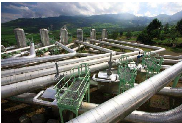
Gambar 2.4 Foto dari Star Energy Geothermal Wayang Windu 1
