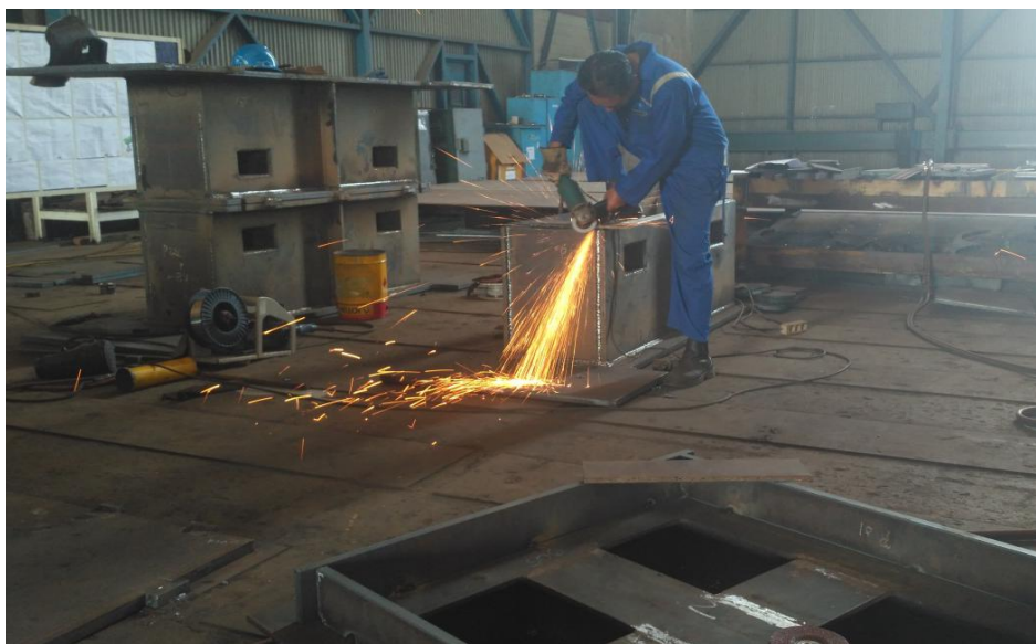
Gambar 4.2 Kondisi Pekerja Tanpa Menggunakan APD saat Grinding .
