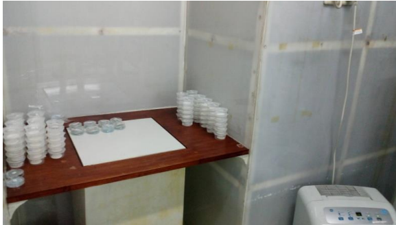
Gambar 3.7 Kondisi filter di ruang bersih
