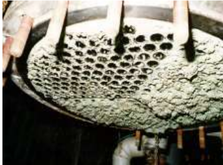
Gambar 2. 5 Fouling pada permukaan heat transfer shell and tube [6]
