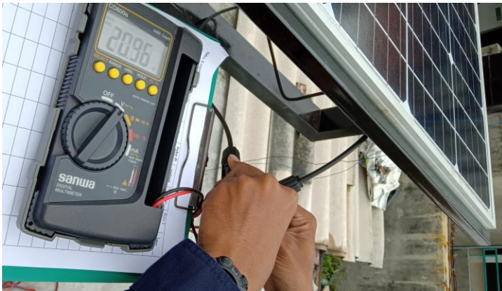
Dokumentasi Pengujian Tegangan keluaran panel surya
