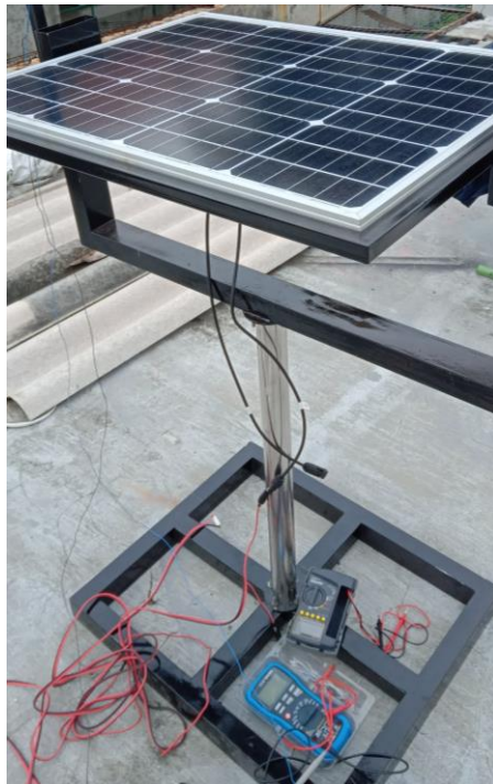
Dokumentasi Kerangka Panel surya 50w
