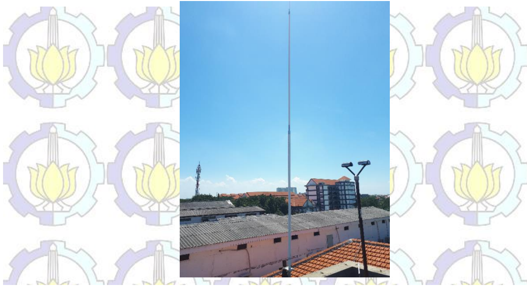
Gambar 3.13 Antena monopole vertikal sebagai pemancar di pasang di atas Gedung B lantai 4
