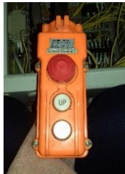
Gambar 4.7 Remote kabel hidrolik
