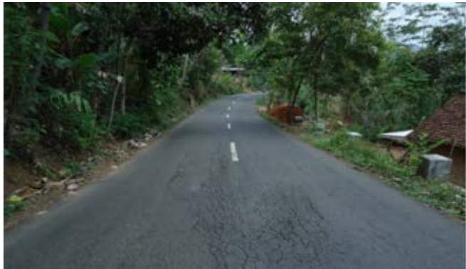
Gambar 5.2 Kondisi Jalan STA 10+200
