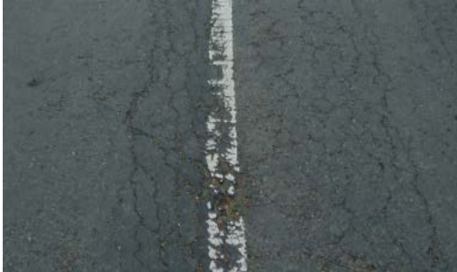
Gambar 5. 1 Kondisi Jalan STA 9+975
