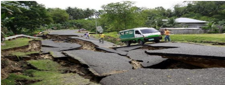
Gambar 4. Jalan Retak dan Hancur
