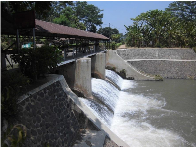
Gambar 4.2 Bangunan Air Plered Sumber : Dokumentasi Penulis
