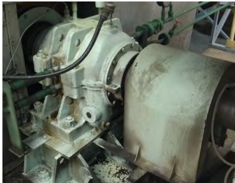
Gambar 25 Motor Listrik Air heater PLTU Unit 3A (Sumber: Dokumentasi Penulis, 2015)
