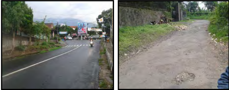
Gambar 4.6 Kondisi Jalan di Jalan Raya Tretes dan Jalan Lingkungan Perkampungan Penduduk
