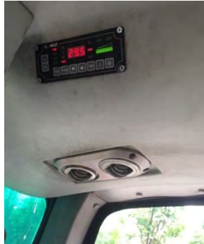
Gambar 4.14: Fasilitas pengatur suhu ruangan bus AC.
