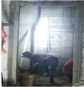
Gambar 4.13 Penerapan Pemakaian Lampu TL-D 36W
