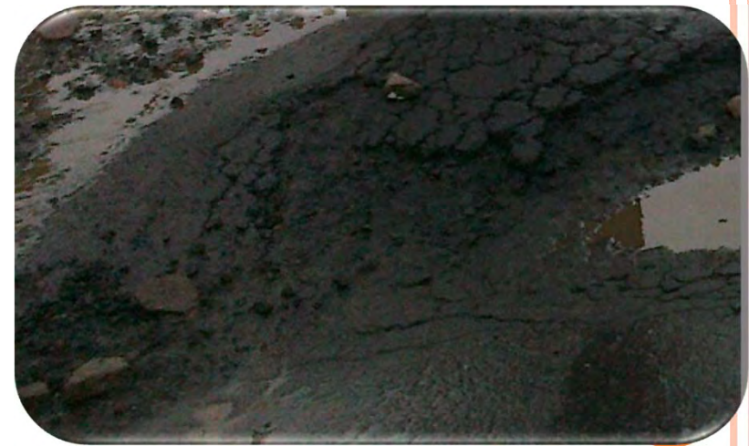
Gambar Kerusakan Aspal Jalan Bojonegoro-Padangan (Sumber : binamarga.jatimprov.go.id)
