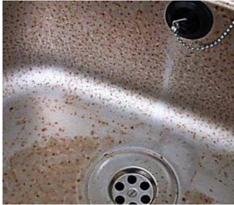
Gambar 2.7 Korosi sumuran pada washtafle
