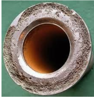
Gambar 2.9 Korosi celah pada sambungan pipa
