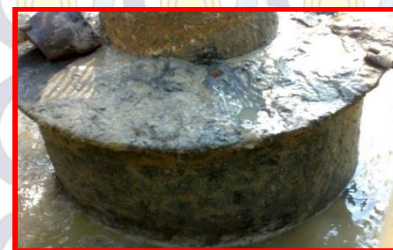
Gambar 4.4. Endapan lumpur pada intake Sea Water Feed Pump
