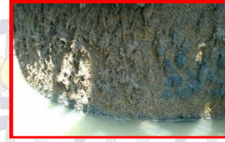
Gambar 4.1. Endapan lumpur pada intake Sea Water Feed Pump
