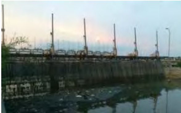
Gambar 2.9 Inlet Rumah Pompa Greges Sumber: Hasil Observasi Lapangan, 2016
