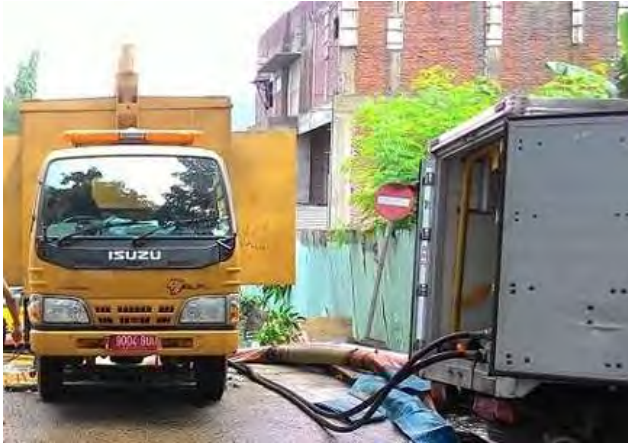
Gambar 5.32 Pompa Non Permanen Sumber: Hasil Observasi Lapangan, 2016
