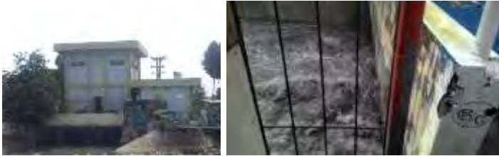
Gambar 2.15 Outlet Rumah Pompa Dupak Bandarejo Sumber: Hasil Observasi Lapangan, 2016
