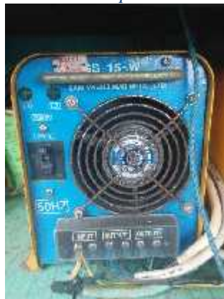
Gambar 3.4 Trafo untuk lampu MH
