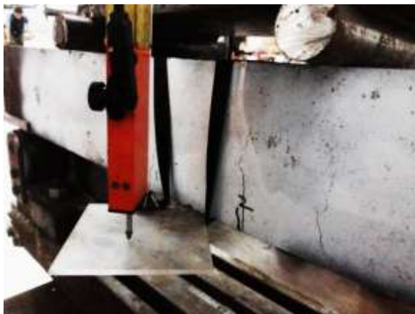
Gambar 4. 9 First Crack pada balok uji 2D10 – 13Apr
