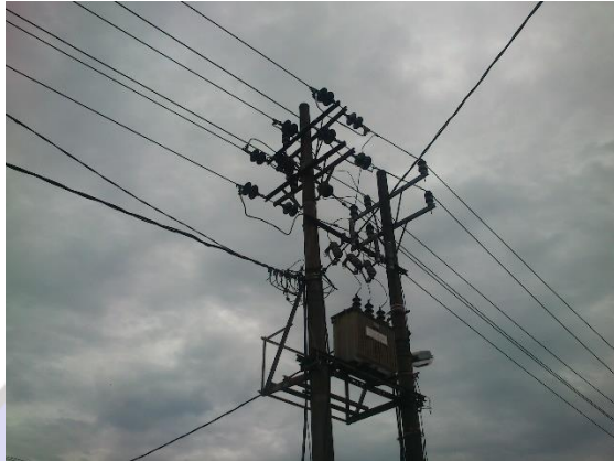
Gambar 2.1 Saluran Udara Tegangan Menengah
