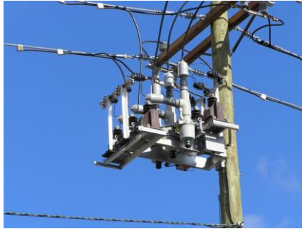
Gambar 2.13 Recloser Pada Jaringan Distribusi
