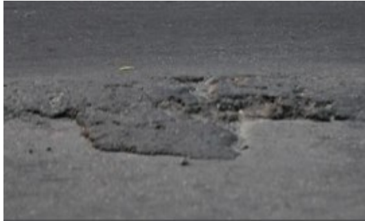
Gambar 2.8 Kerusakan Jalan Flushing
