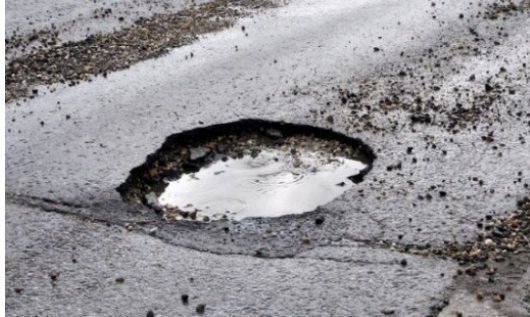
Gambar 2.1 Kerusakan Jalan Potholes
