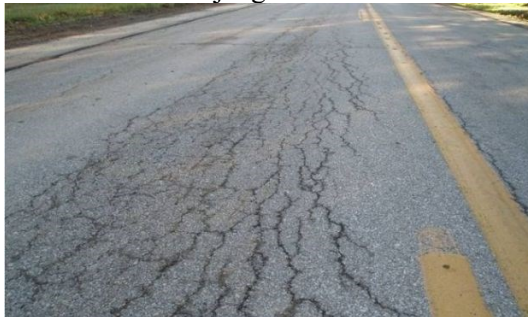
Gambar 2.6 Kerusakan Jalan Longitudinal Crack
