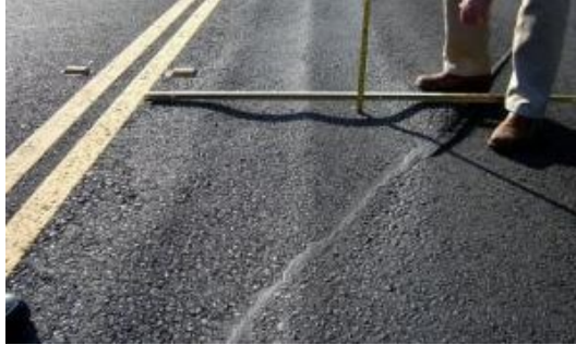
Gambar 2.7 Kerusakan Jalan Rutting
