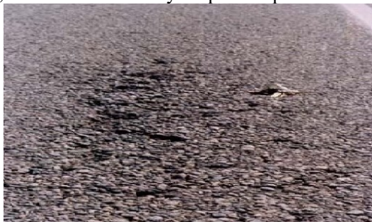
Gambar 2.3 Kerusakan Jalan Ravelling
