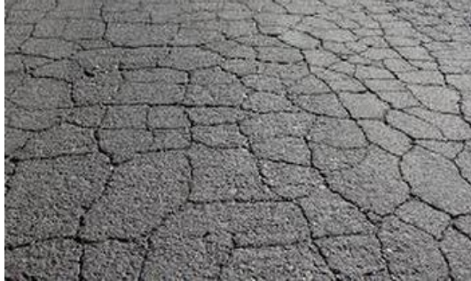
Gambar 2.2 Kerusakan Jalan Alligator Cracking
