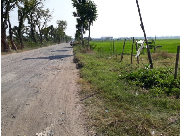
Gambar 1.5 Kondisi saluran samping (drainase)
