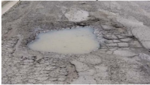
Gambar 2.4 Kerusakan Jalan Amblas Sumber: (Ziantono, 2016)
