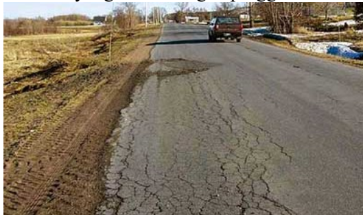
Gambar 2.9 Kerusakan Jalan Edge Cracking
