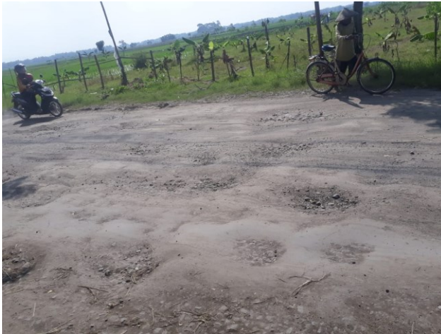
Gambar 1.2 Kerusakan Perkerasan yang cukup parah
