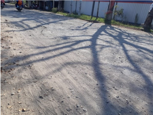
Gambar 1.3 Kerusakan perkerasan yang berupa terkelupasnya lapisan aspal
