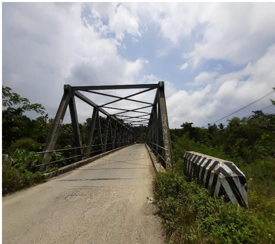
Nama Jembatan : Yaka Jenis Jembatan : Rangka Baja Bentang : 50 meter Lokasi : Ruas Sarmi-Sentani
