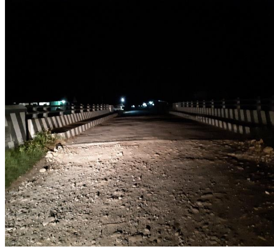
Nama Jembatan : Kali Os Jenis Jembatan : Girder Bentang : 20 meter Lokasi : Ruas Sarmi-Sentani
