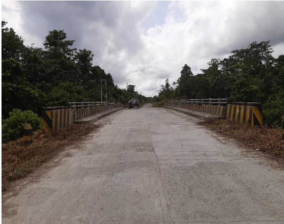
Nama Jembatan : Sosiri II Jenis Jembatan : Girder Bentang : 25 meter Lokasi : Ruas Sarmi-Sentani
