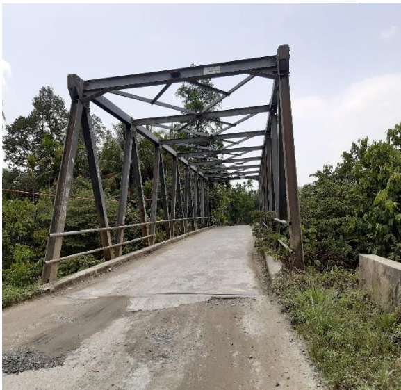
Nama Jembatan : Kertosari V Jenis Jembatan : Rangka Baja Bentang : 25 meter Lokasi : Ruas Kertosari-Sentani
