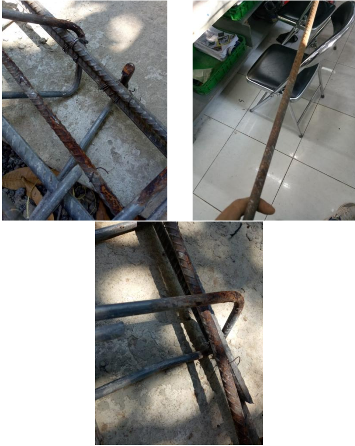
Foto Contoh Korosi Pada Tulangan Memanjang Sebelum Dibersihkan
