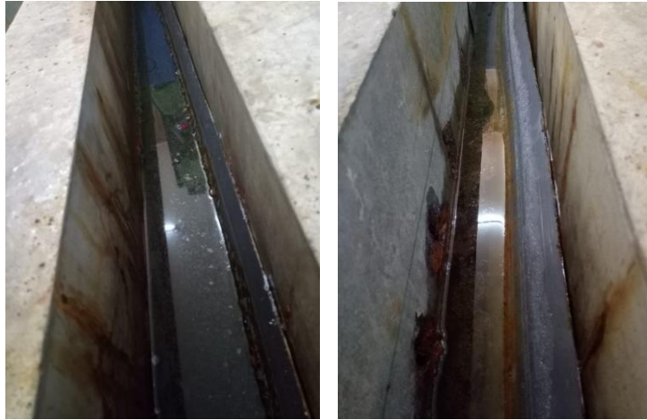
Foto Korosi Pada Sisi Panjang Balok
